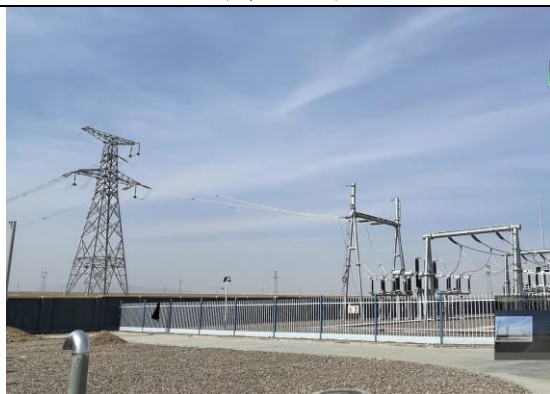
送出线路及塔基
